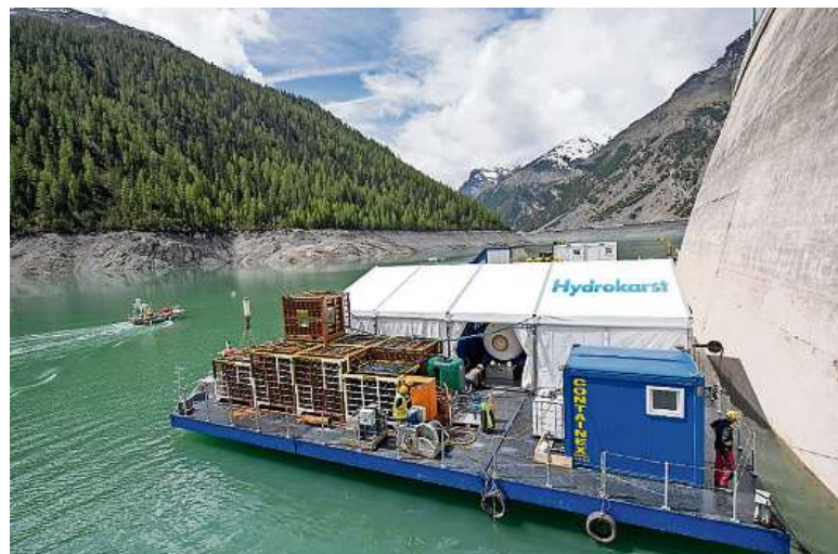
Derzeit herrscht «Tauchpause» auf dem Stausee Livigno : Nur noch wenige Arbeiter befinden sich auf der schwimmenden Baustelle. (FOTO OLIVIA ITEM)
